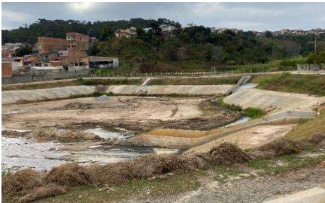
Figura 39 – Reservatório de detenção
