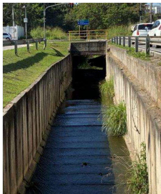
Figura 97- Vista da travessia a jusante – canal de seção retangular a céu aberto entre a Avenida P. Getúlio Vargas e Avenida Santa Maria
