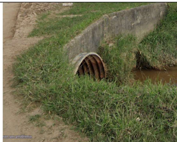
Figura 18 – Bueiro Tubular de Aço Corrugado – Diâmetro = 2,0 m
